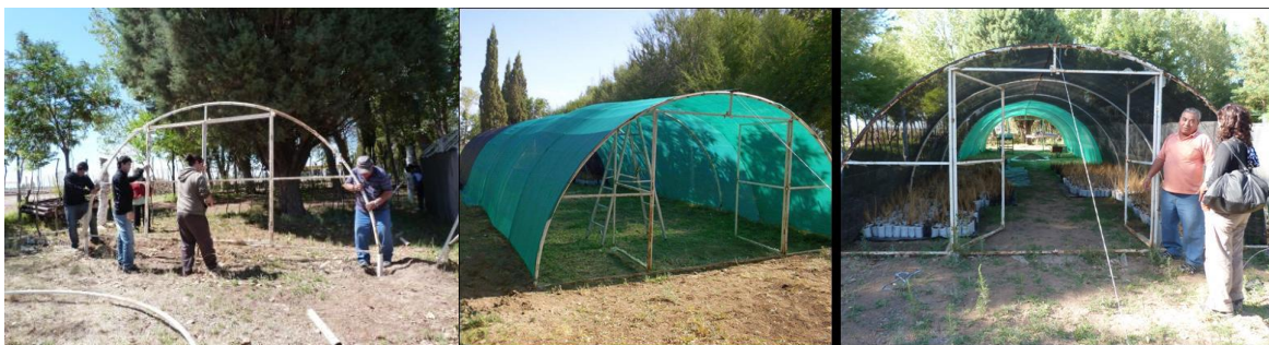
Figura 86. Armado de la infraestructura en el vivero CCó. Izq. Anclaje de estructuras en hormigón. Centro y derecha: sector de rustificación terminado.
