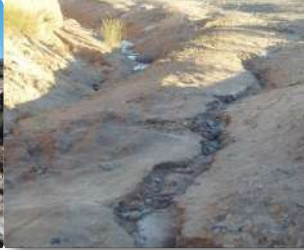
Erosión hídrica, carcavamiento de ladera
