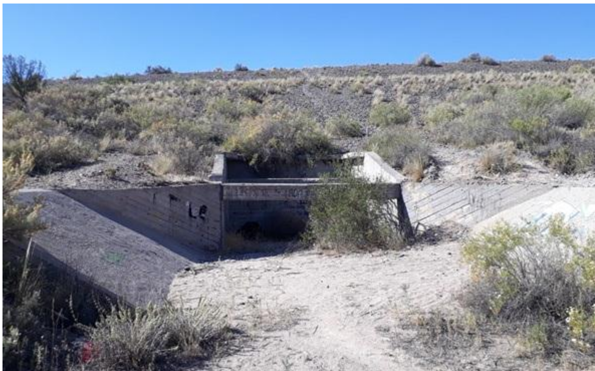
Imagen 11. Disipador de energía, salida derecha.
