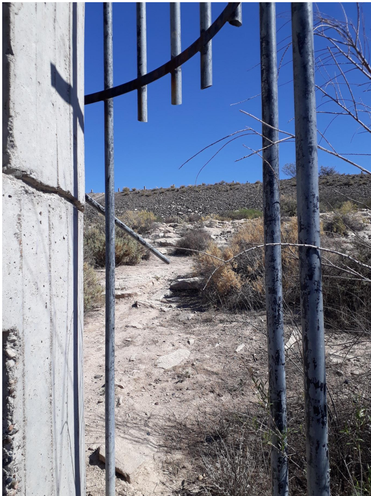
Imagen 7. Estado de rejas tubulares, toma izquierda.
