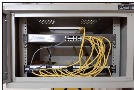
Figura 24. Rack de distribución del Sector de CNC luego de la mejora.
