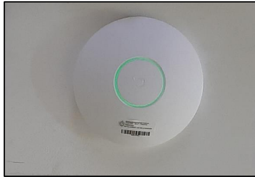
Figura 22. AP Wifi ubicado en edificio de Física.
