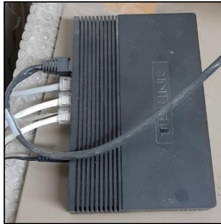
Figura 13. Switch ubicado en la planta baja del LENoD.
