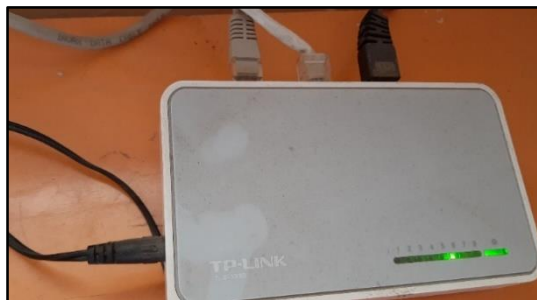
Figura 14. Switch ubicado en la planta alta del LENoD.
