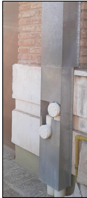
Figura 12. Ingreso de la fibra óptica al Edificio LENOD.
