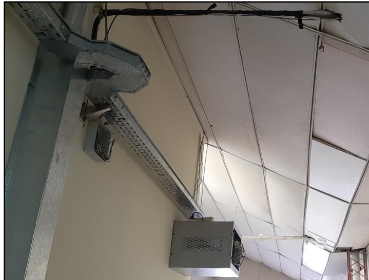
Figura 20. Cableado estructurado y rack del edificio de Física.
