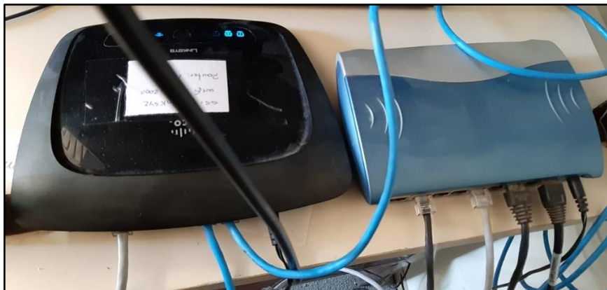
Figura 11. Dispositivos finales de red para red inalámbrica y cableada.
