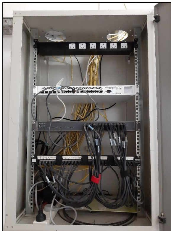
Figura 27. Rack principal de Dpto. de Química luego de la mejora.
