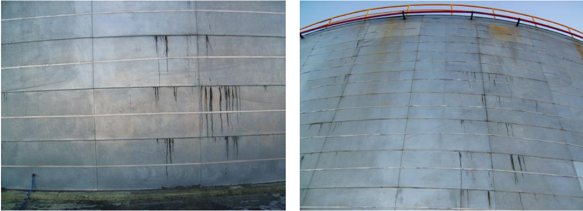
(a) (b) Figura 5.26: Existencia de filtraciones de petróleo en la envolvente del tanque analizado: (a): Virolas inferiores, (b): Virolas superiores.
