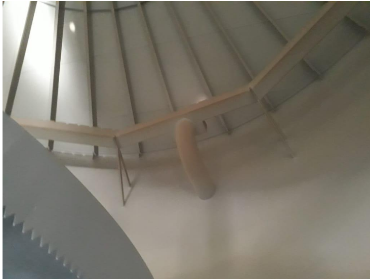
Figura 3.4: Cañería de rebalse.
