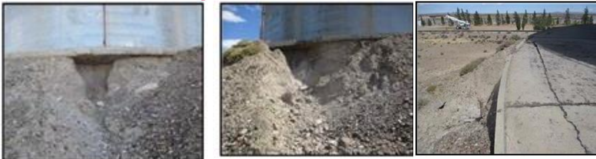
Figura 3.10: Socavación de terraplén y fisuras en la de base de hormigón (2016).
