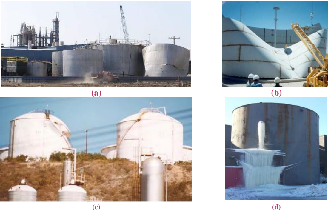
Figura 2.3: Pandeo de tanques: (a) Falla por Huracán Katrina, Fish Oil, Port Sulphur (2005), (b) Falla por viento en etapa constructiva, Patagonia Argentina (2001), (c) Falla por descenso en apoyo, Puerto Rico (2010), (d) Falla por corrosión.
