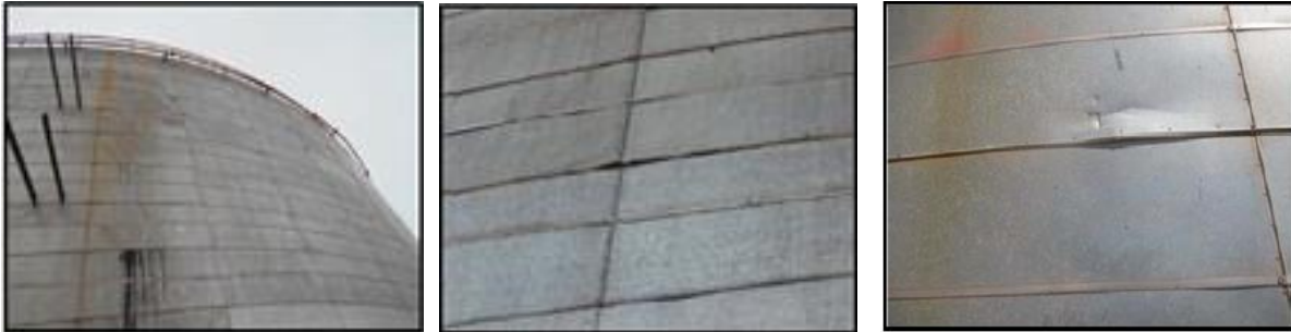
Figura 3.8: Derrame de producto y deterioro en revestimiento (2016).
