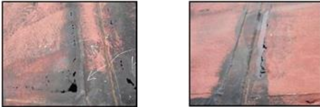
Figura 3.9: Corrosión en el techo (2016).
