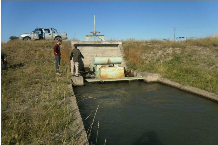
Imagen 2: Compuerta AVIO, toma del secundario VII
