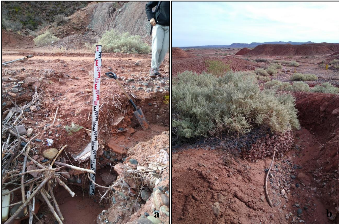
Figura 5.5. a) Relleno antrópico del cauce aguas abajo de la cuenca C23. b) Gavión que afecta el cauce aguas abajo de la cuenca C23
