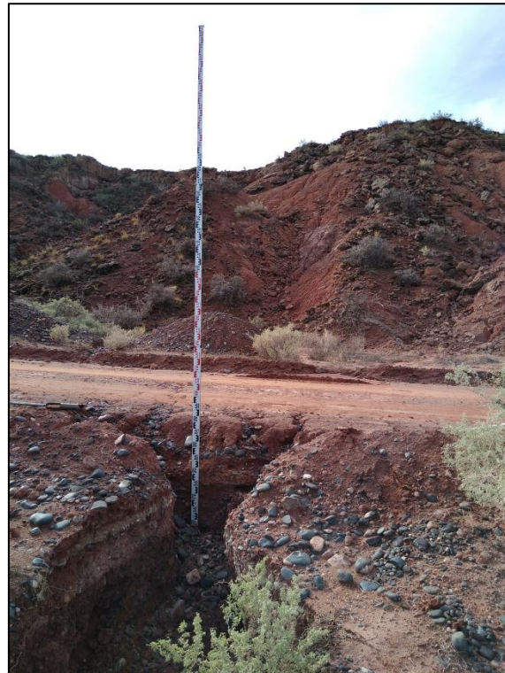
Figura 5.6. Relleno antrópico del cauce aguas abajo de las cuencas C20 y C21
