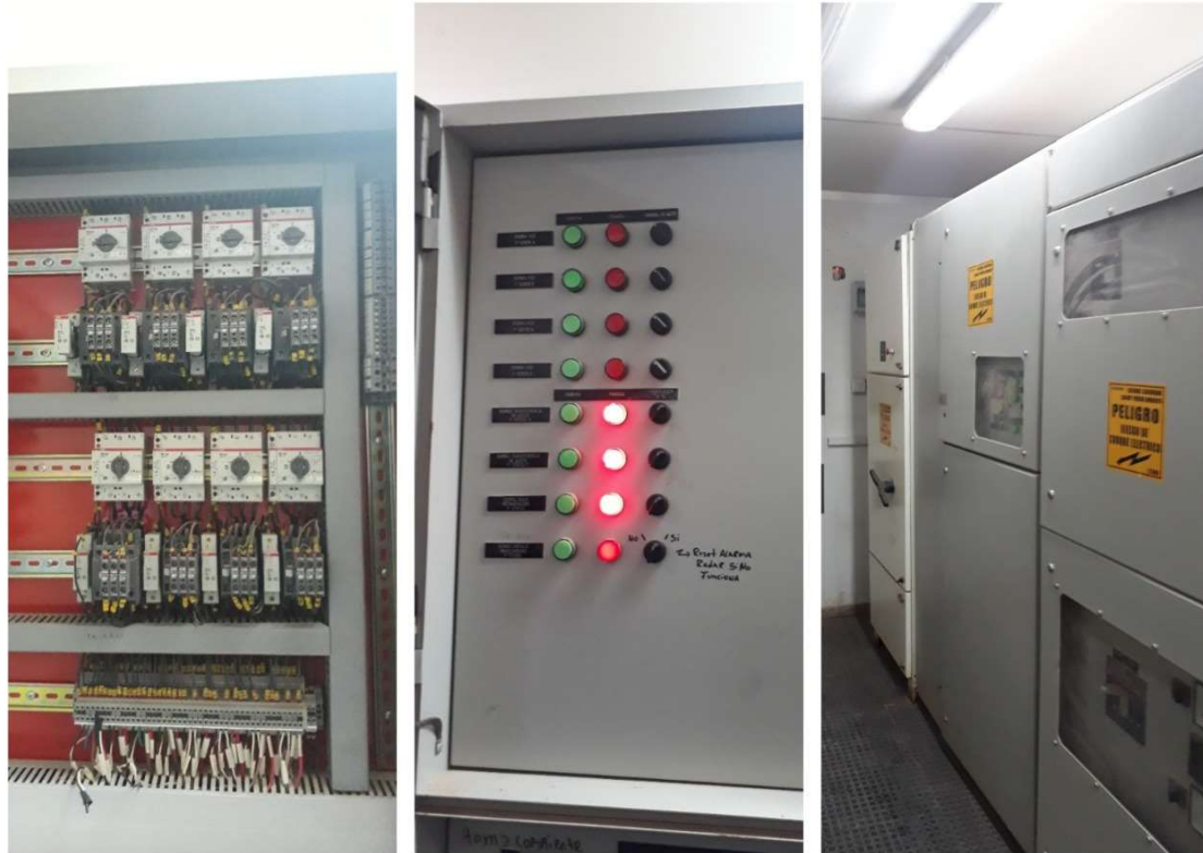
Imagen 16: Relevamiento tablero CCM existente.
