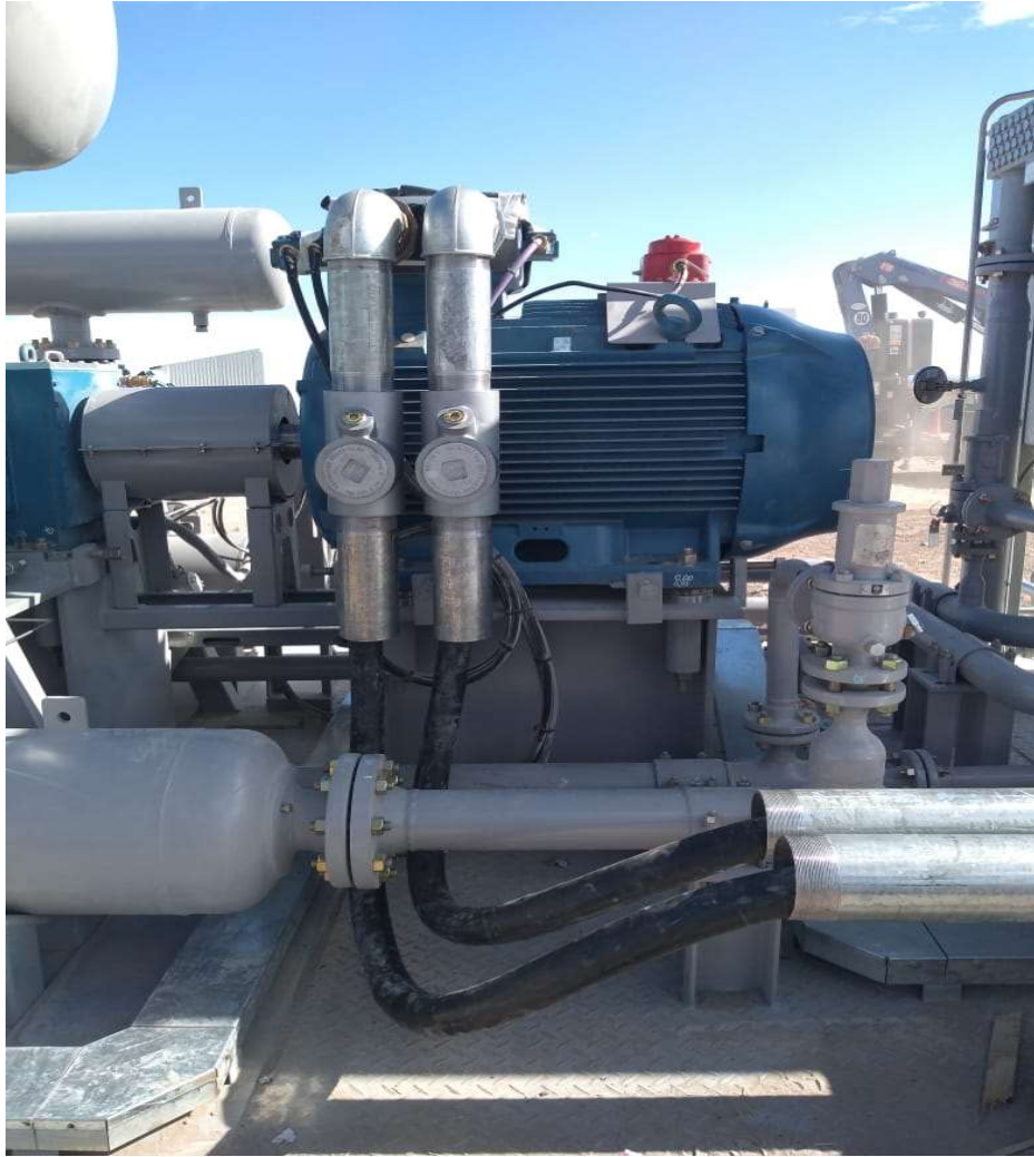
Imagen 14: Acometida APE en compresores de gas.
