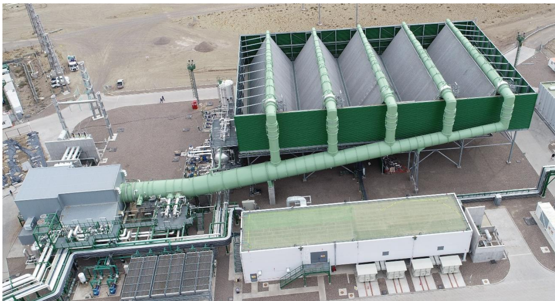
Figura 2-14: Vista aérea de aerocondensador que completa el ciclo combinado Cerro Dragón 2- Pan American Energy. Manual de Operaciones Upstream (2020)
