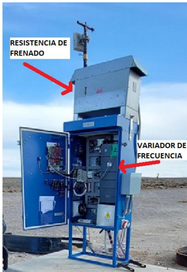
Figura 2-40: Fotografía de tablero de control con resistencia de frenado en pozo con motor de imán permanente.
