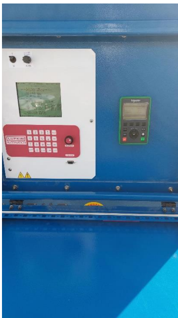
Figura 2-36: Fotografía de tablero de pozo con motor de imán permanente, a la izquierda (caja blanca) controlador Pump Off del AIB; a la derecha (con bordes verdes) variador de frecuencia del motor
