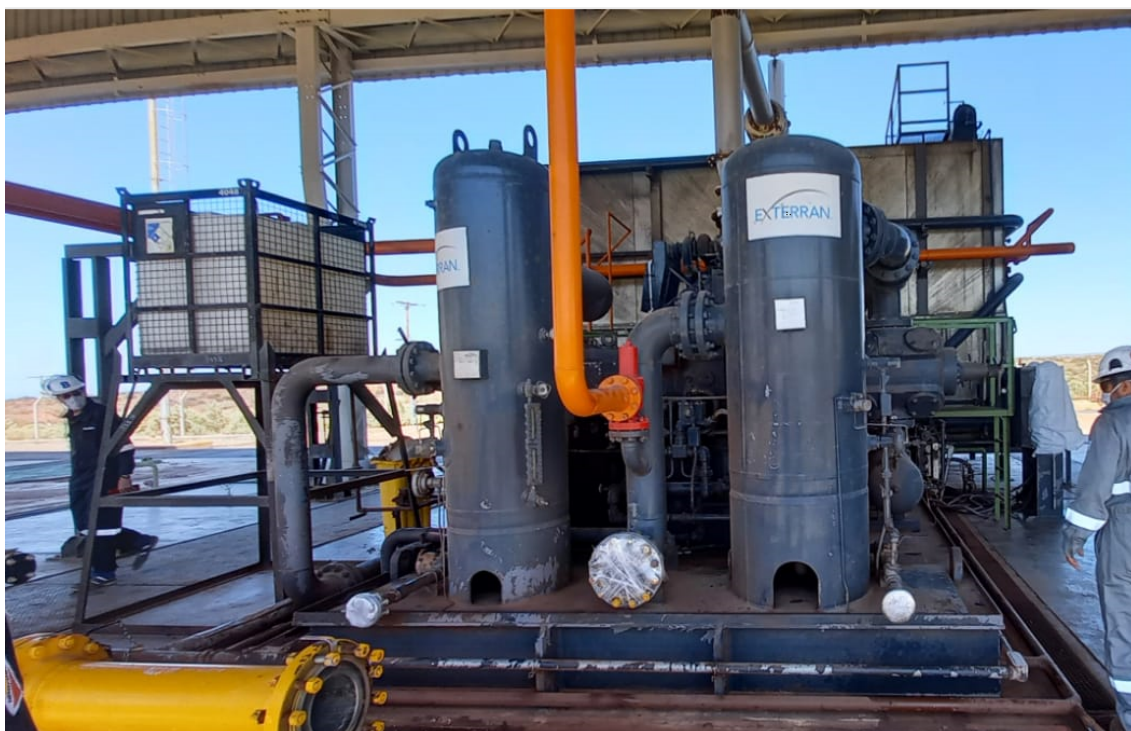
Figura 19. Equipo motocompresor en la base, previo a su traslado.
