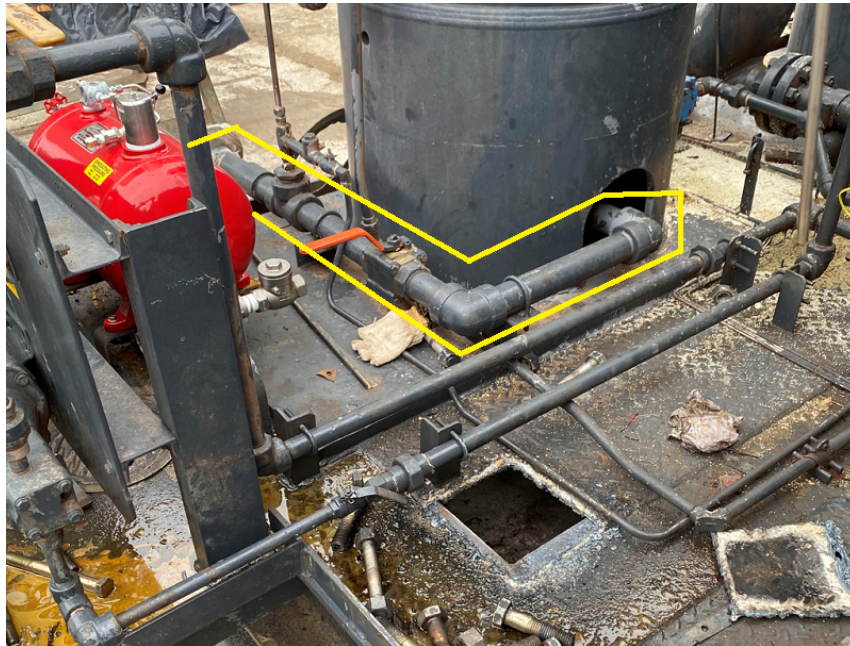
(c) Conducción de residuo desde los scrubbers hasta el blowcase.
