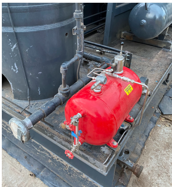
Figura 8. Blowcase montado sobre skid .
