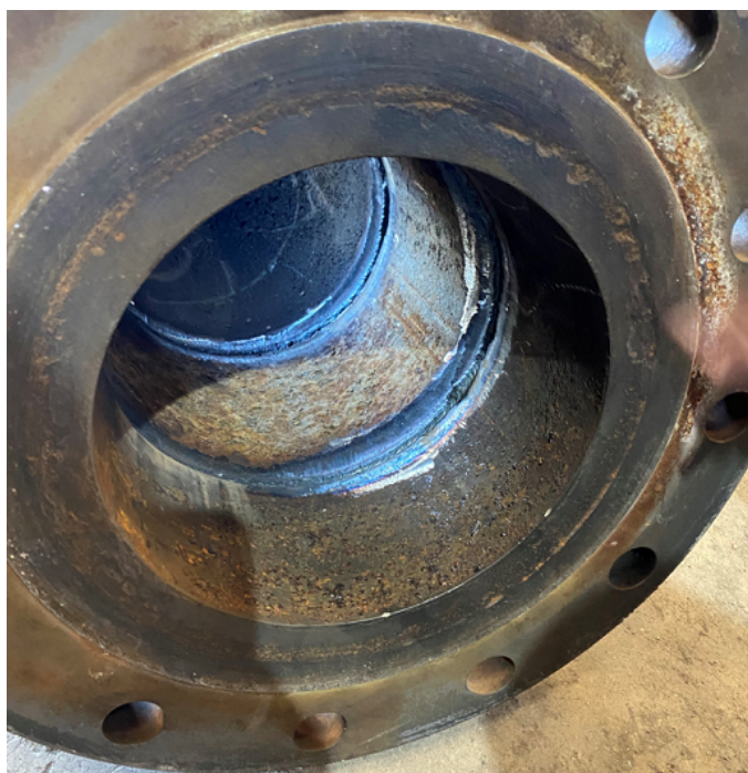
Figura 41. Detalle de la brida e interior del codo con indicaciones visuales.
