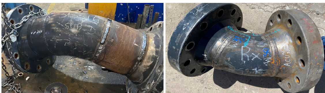
(a) Codo conexión scrubber pulsador 1era etapa.
