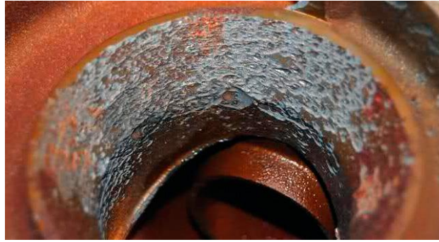
Figura 7: Ejemplo de corrosión por erosión
