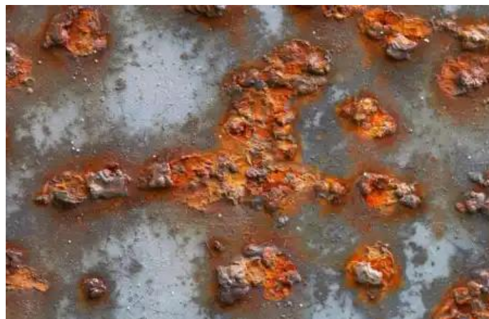
Figura 4: Ejemplo de corrosión intergranular
