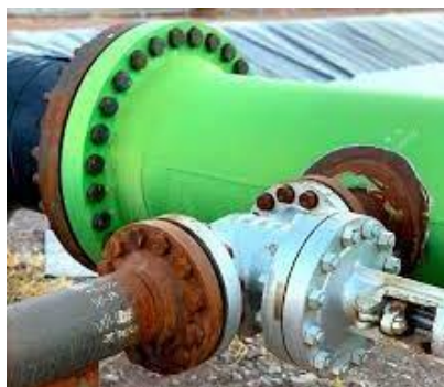
Figura 2: Ejemplo de corrosión galvánica
