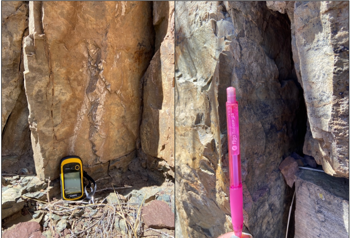
Figura 24. Diaclasas verticales correspondientes a la familia de discontinuidades J2. En: a) Diaclasa con una extensión de 1 m y abertura de 1 cm con ausencia de relleno y rugosidades escalonadas; b) Ondulaciones rugosas y alteración en las paredes de la discontinuidad.
