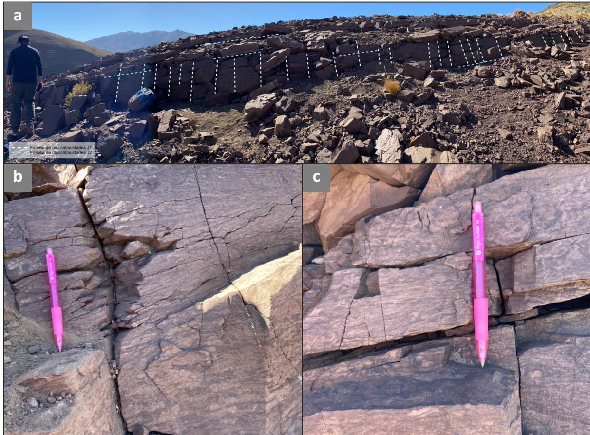
Figura 20. a) Areniscas finas rojizas que conforman la estación geomecánica 1. Con líneas punteadas se identifican las redes de diaclasas que afectan el afloramiento; b) Diaclasas subverticales abiertas pertenecientes a la familia de discontinuidades J1; c) Diaclasas horizontales con mayor abertura, correspondientes a la familia de discontinuidades J2.
