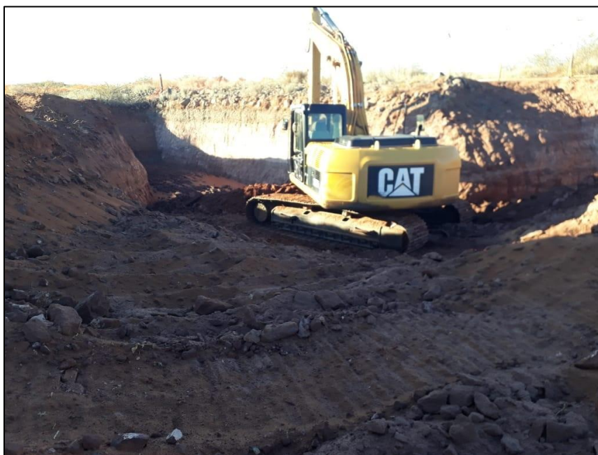
Foto N°2: Saneamiento de un derrame de hidrocarburo.
