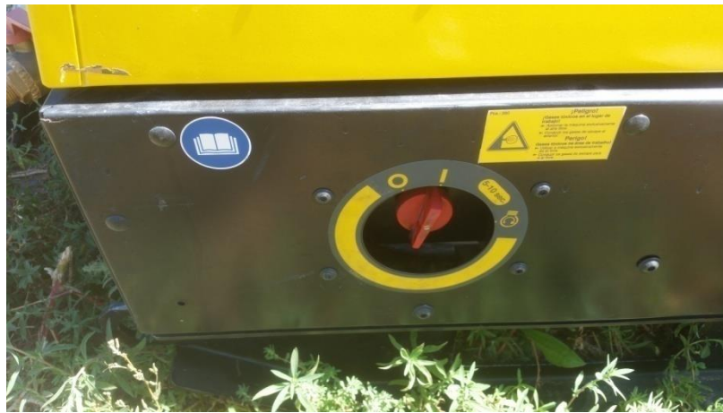
Imagen 22. Arranque de Motocompresor. Fuente: Propia
