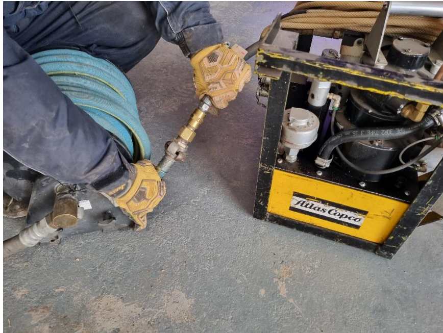
Imagen 19. Conexión de bomba. Fuente: Propia
