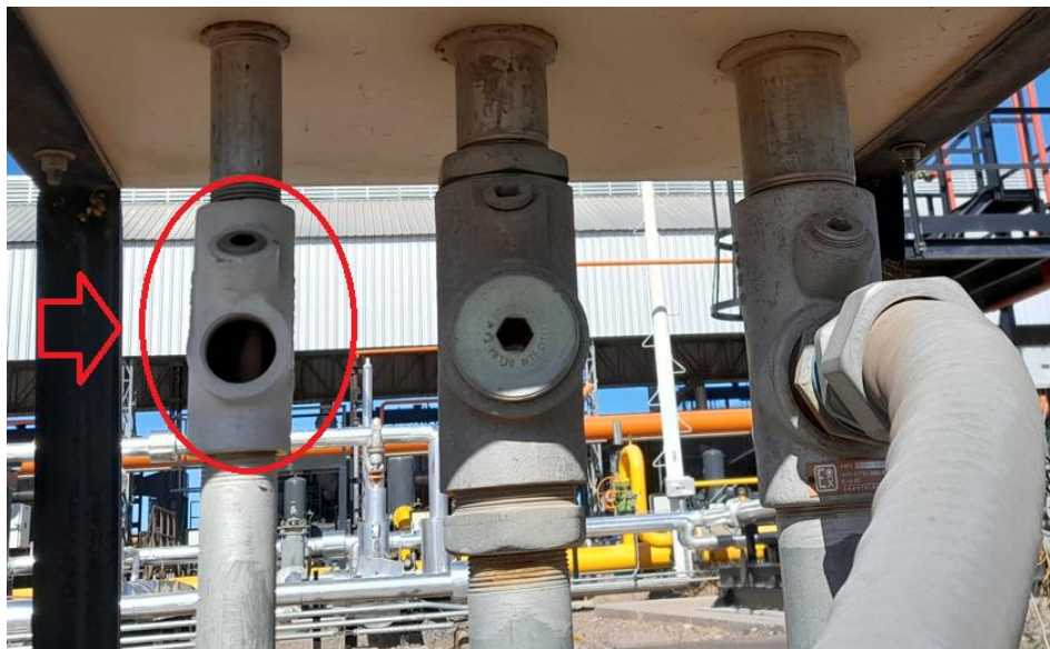
Imagen 32: desvío detectado en Tablero VDF A
