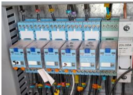
Imagen 46: conexiones con fusibles en tablero grupo
