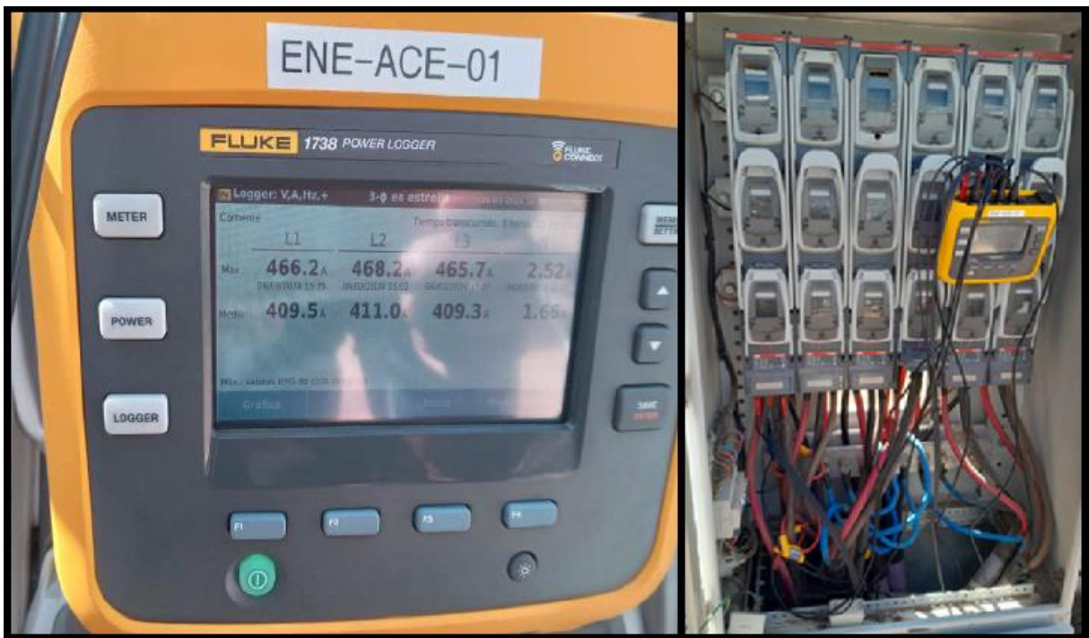
Ilustración 39: Medición de energía con instrumento FLUKE 1738
