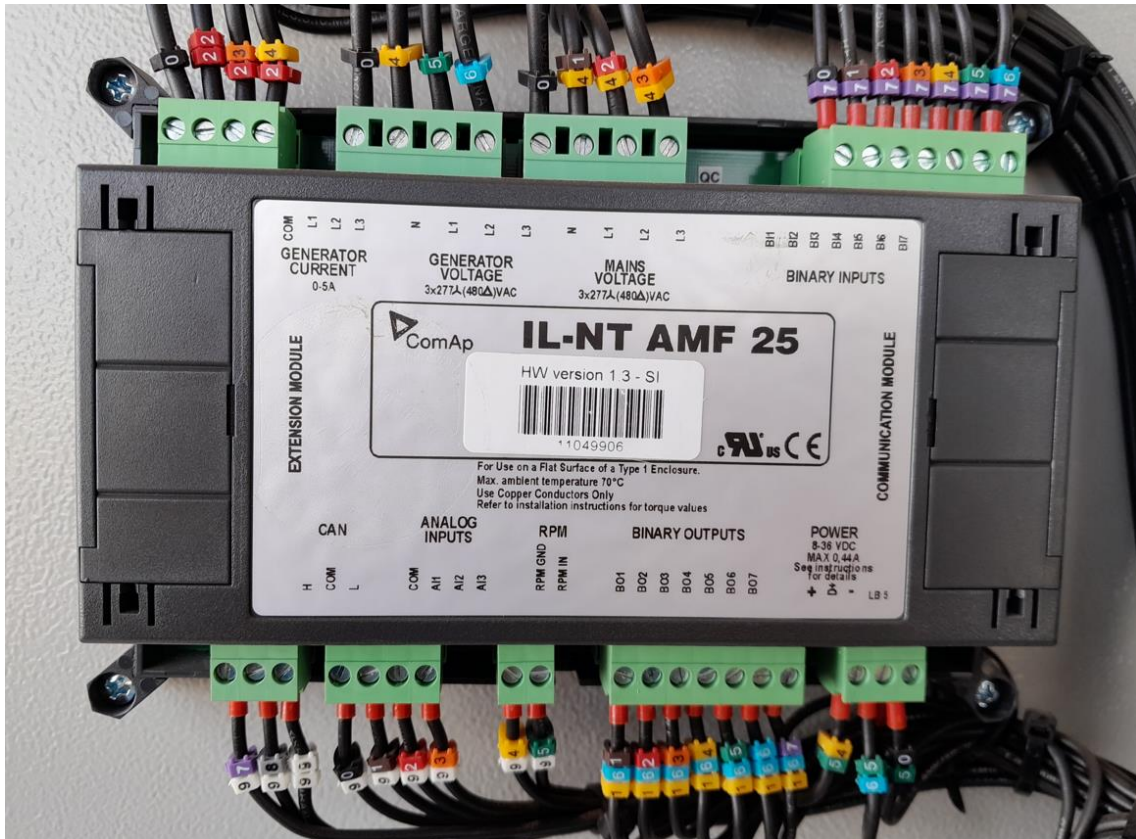
Imagen 48: Controlador tablero grupo
