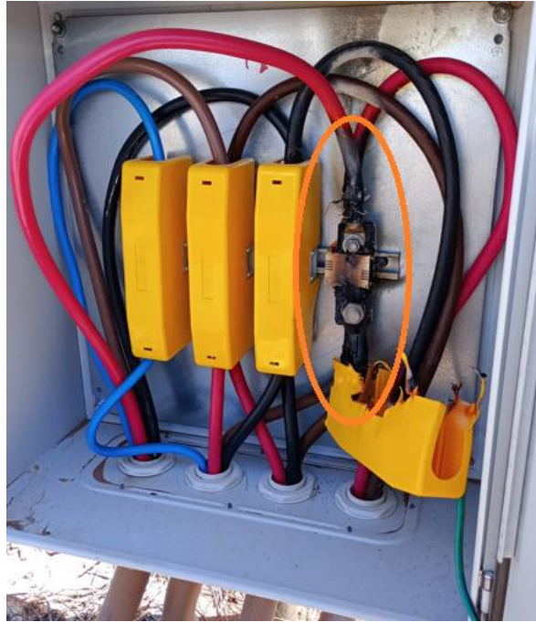
Ilustración 35: Exceso de temperatura en punto de conexión sobre uno de los tableros de interconexión
