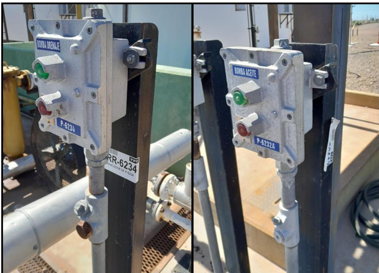
Imagen 39: Pulsadores bombas "ACEITE"
