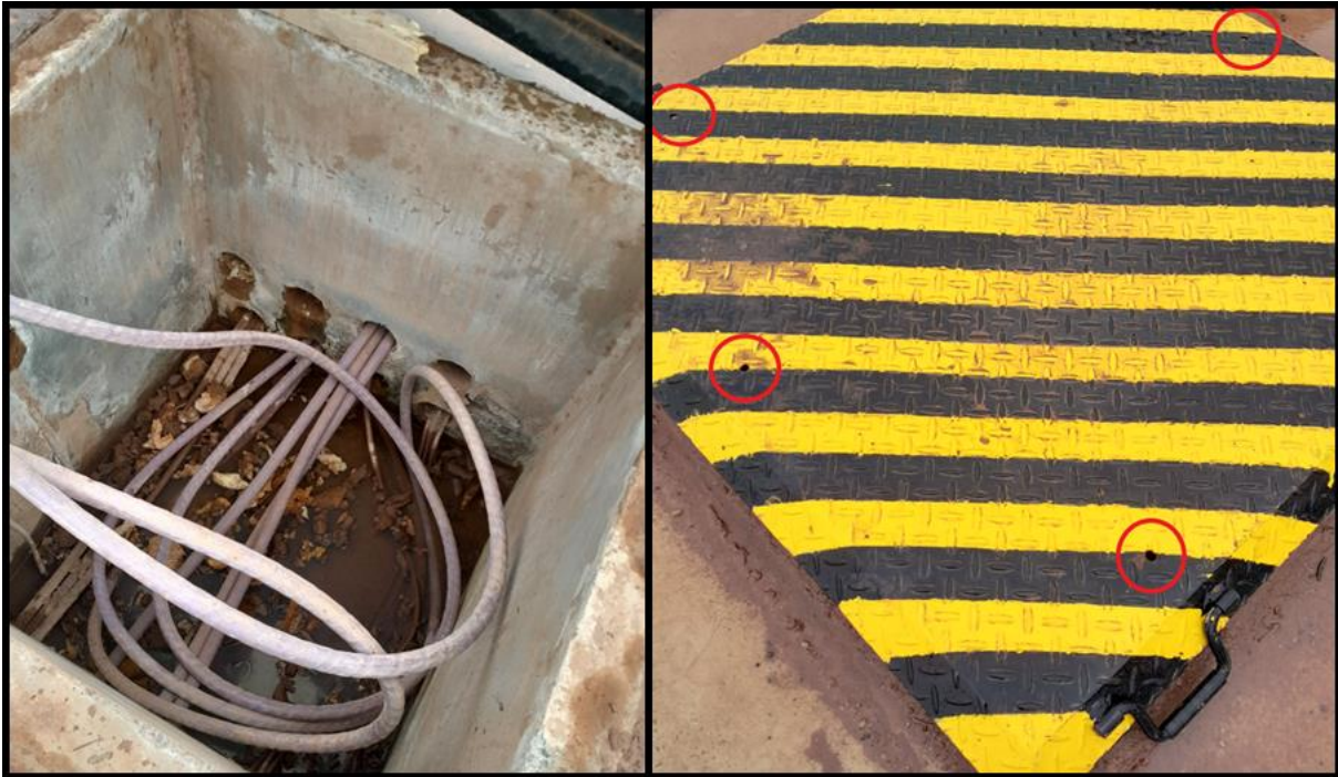
Ilustración 17: Cámara con presencia de agua y tapa de cámara con hueco
