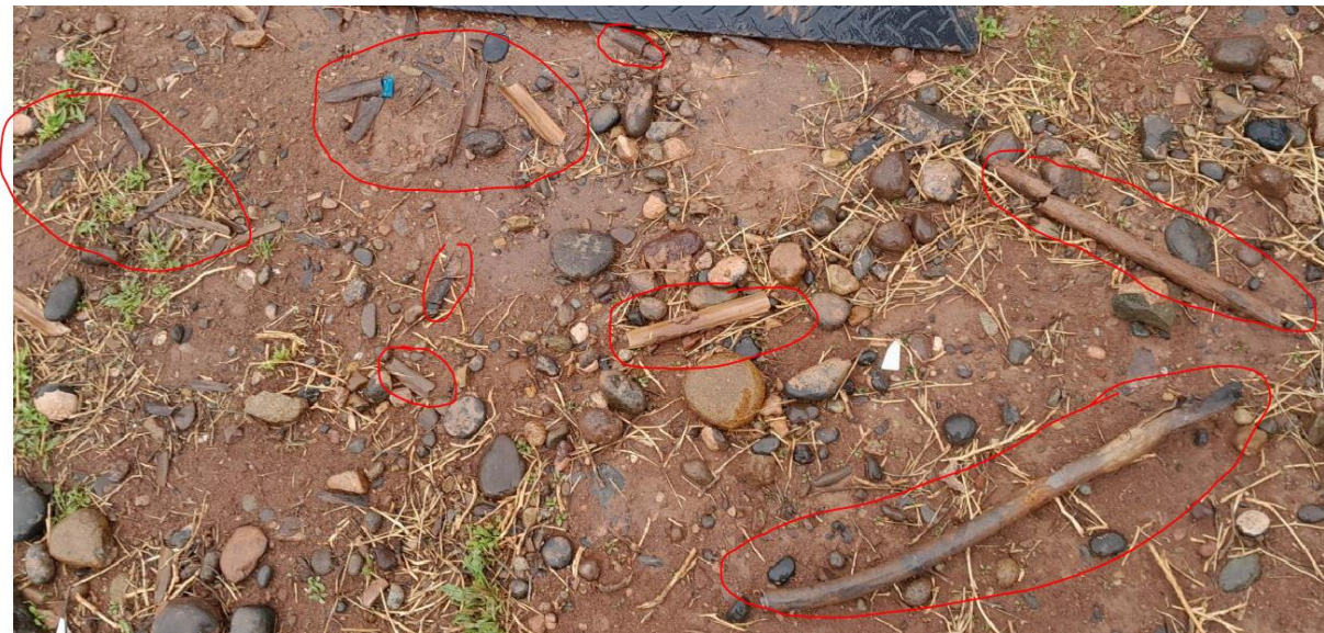
Ilustración 16: trozos de cubierta reseca del cable que produjo la falla
