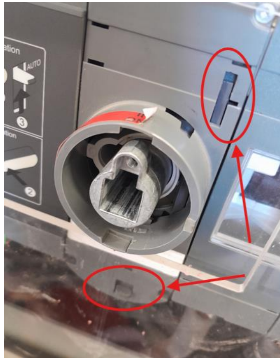
Ilustración 69: Llave conmutadora transferencia con falla mecánica en pestillos rotos que no trababan
