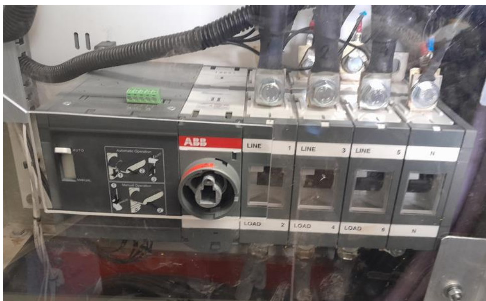
Ilustración 70: Llave conmutadora ABB nueva montada
