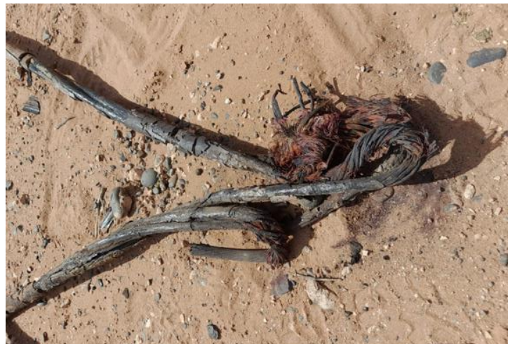
Ilustración 36: calcinamiento de conductor principal entre Transformador MT/BT y tablero principal BT
