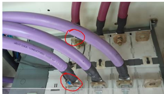
Ilustración 63: imagen de la conexión de las fases sobre el conmutador automático ABB
