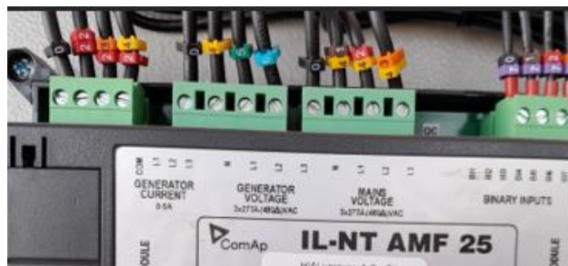
Ilustración 62: Imagen de las señales de tensión sobre el controlador del generador
