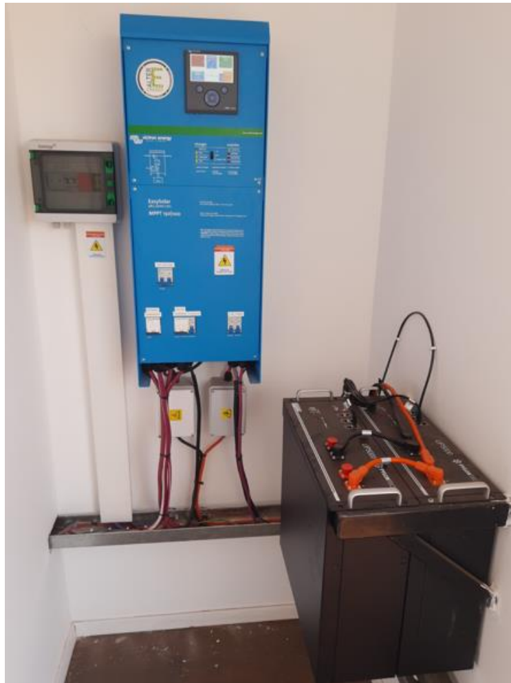
Imagen 13: Sistema de control del sistema más banco de baterías
