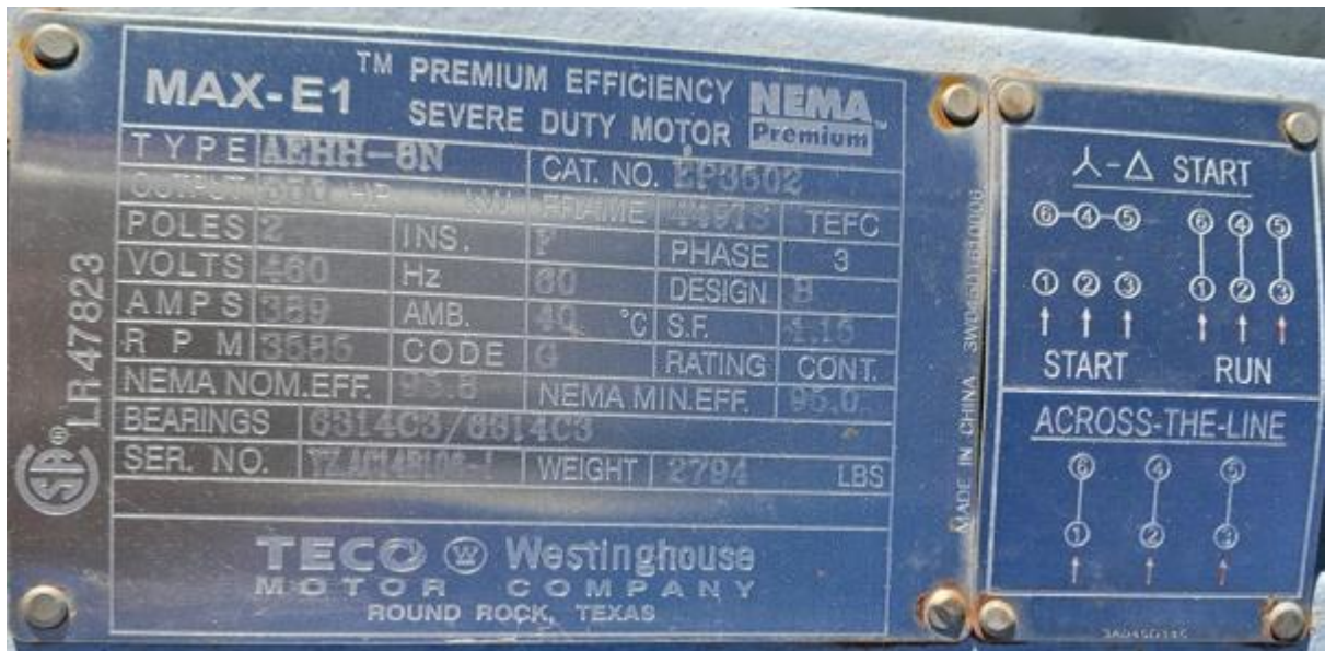
Imagen 22: Placa característica de uno de los motores de las bombas principales
