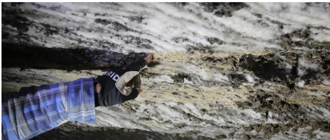
Figura 6-17: Marcas lineales de precipitados y sedimentos a una altura de 1.7 metros aproximadamente desde el suelo, que resultan de episodios de inundación en el interior de la cueva. Estas evidencias fueron registradas en el acceso a la Sala de las Chimeneas.
