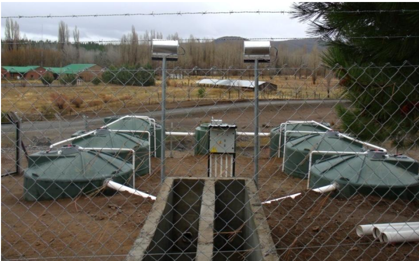
Planta de tratamiento de efluentes cloacales. B. Riscos Bayos. 2015.
