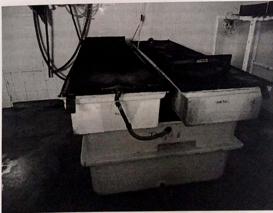
Imagen 2: Sistema de recirculación una bomba 0,75 HP
