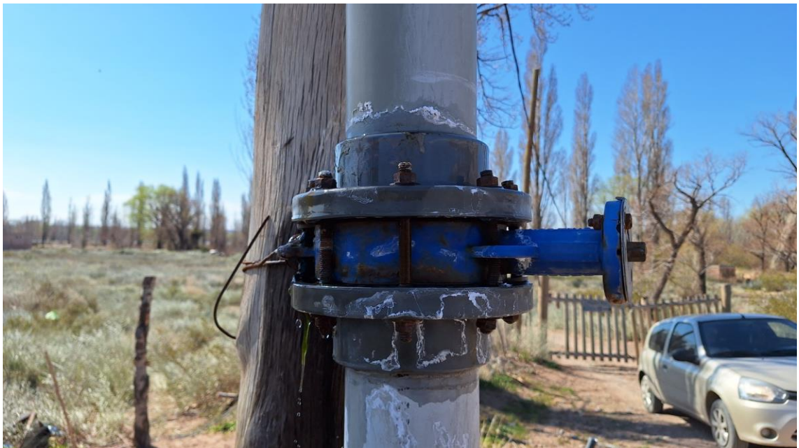
Figura 13. Válvula mariposa de apertura a chimenea con pérdidas de fluido y salinidad.
