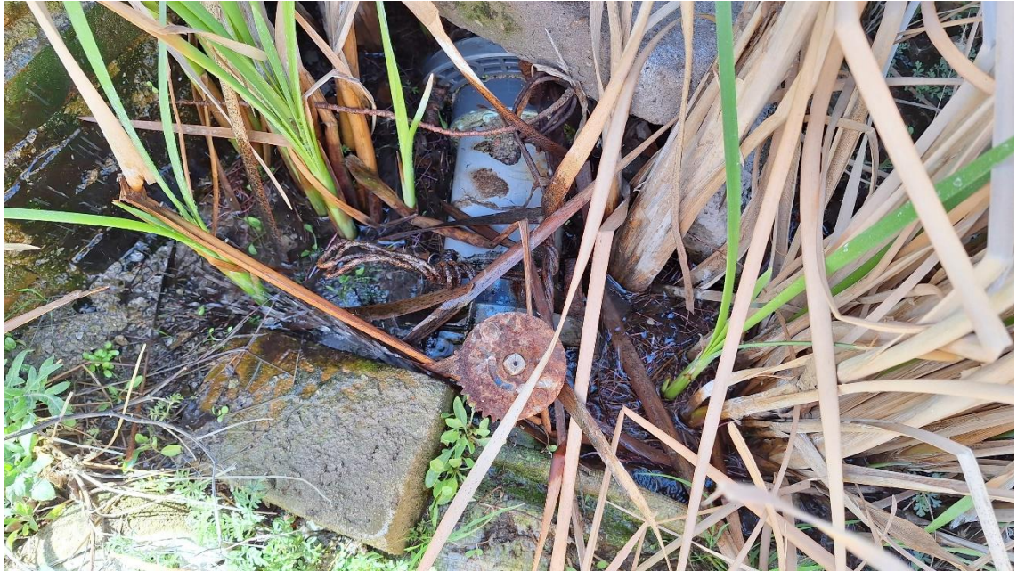
Figura 12. Fotografía de válvula en el exterior del recinto donde se extrae agua.
