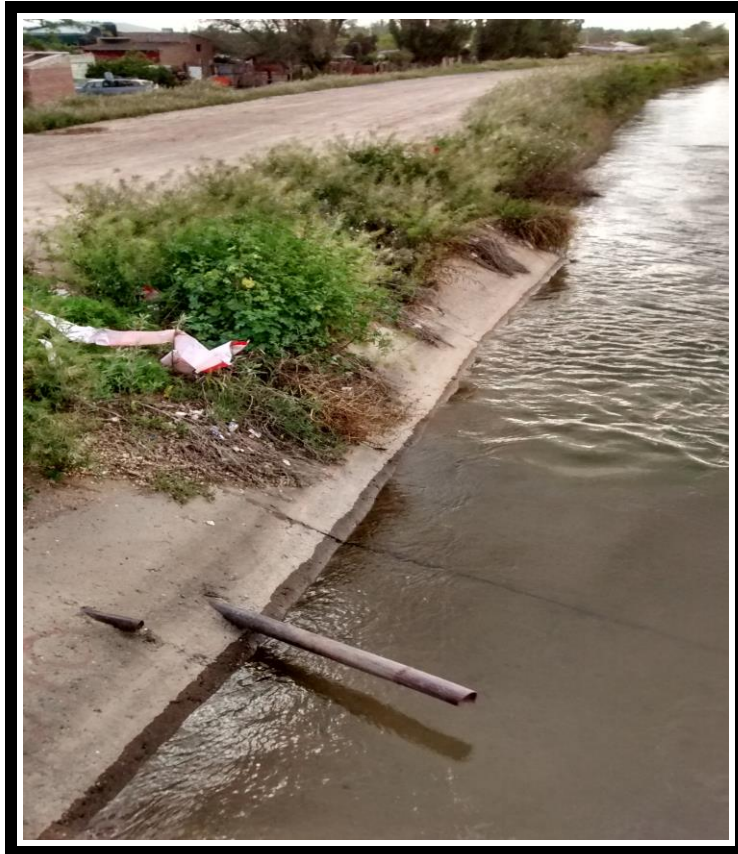
Figura 27: Conexión de cañería de descarga de efluentes al Canal Principal de Riego.
