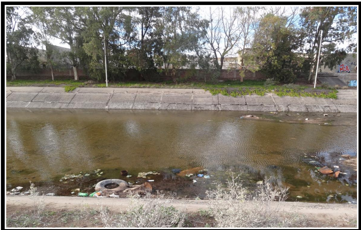
Figura 24: Acumulación de residuos sólidos en el fondo del cauce del Canal Principal de Riego.
